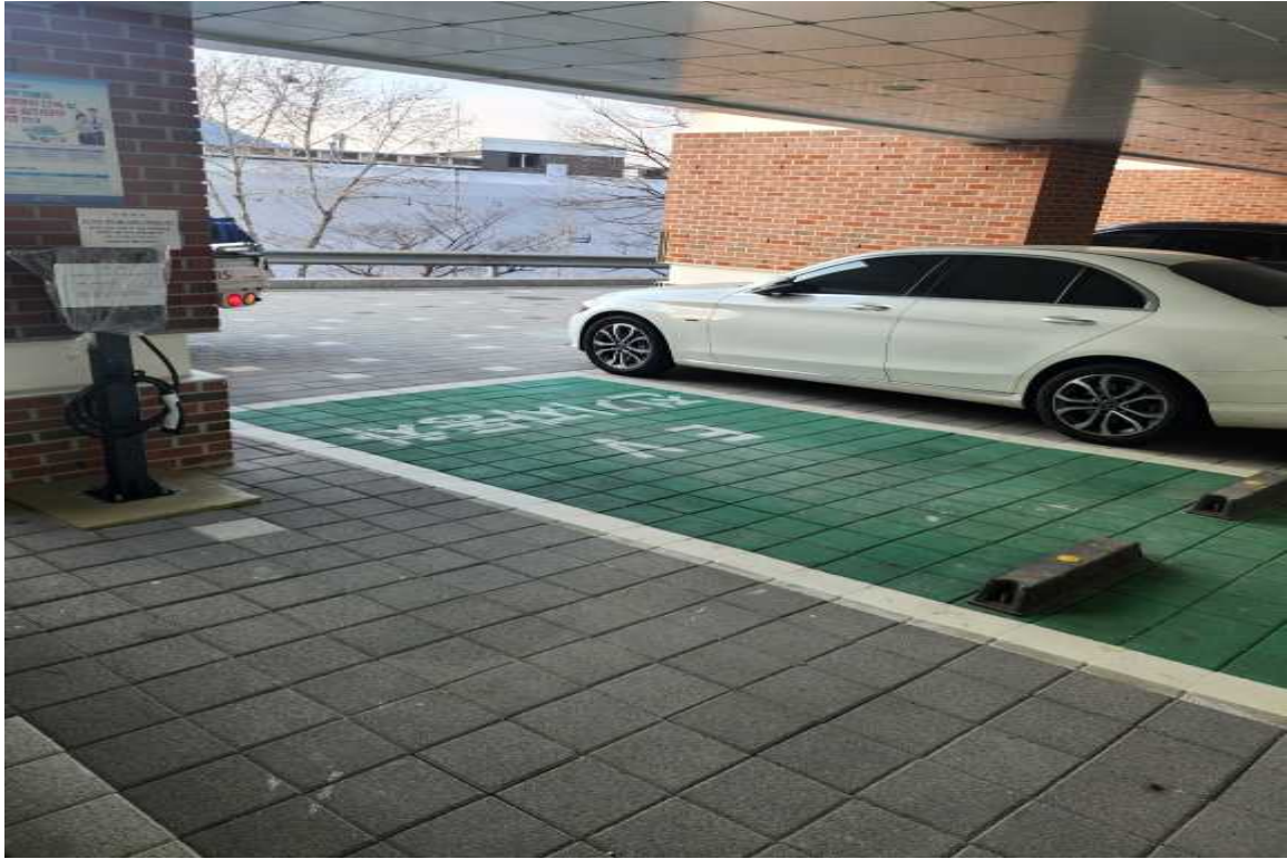
69동(실험동물자원연구동) 지하 주차장 완속충전기 1대
