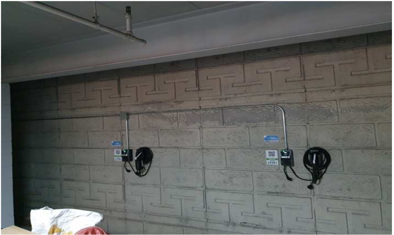
76-1동(주차타워) 지하1층 충전기 2대
