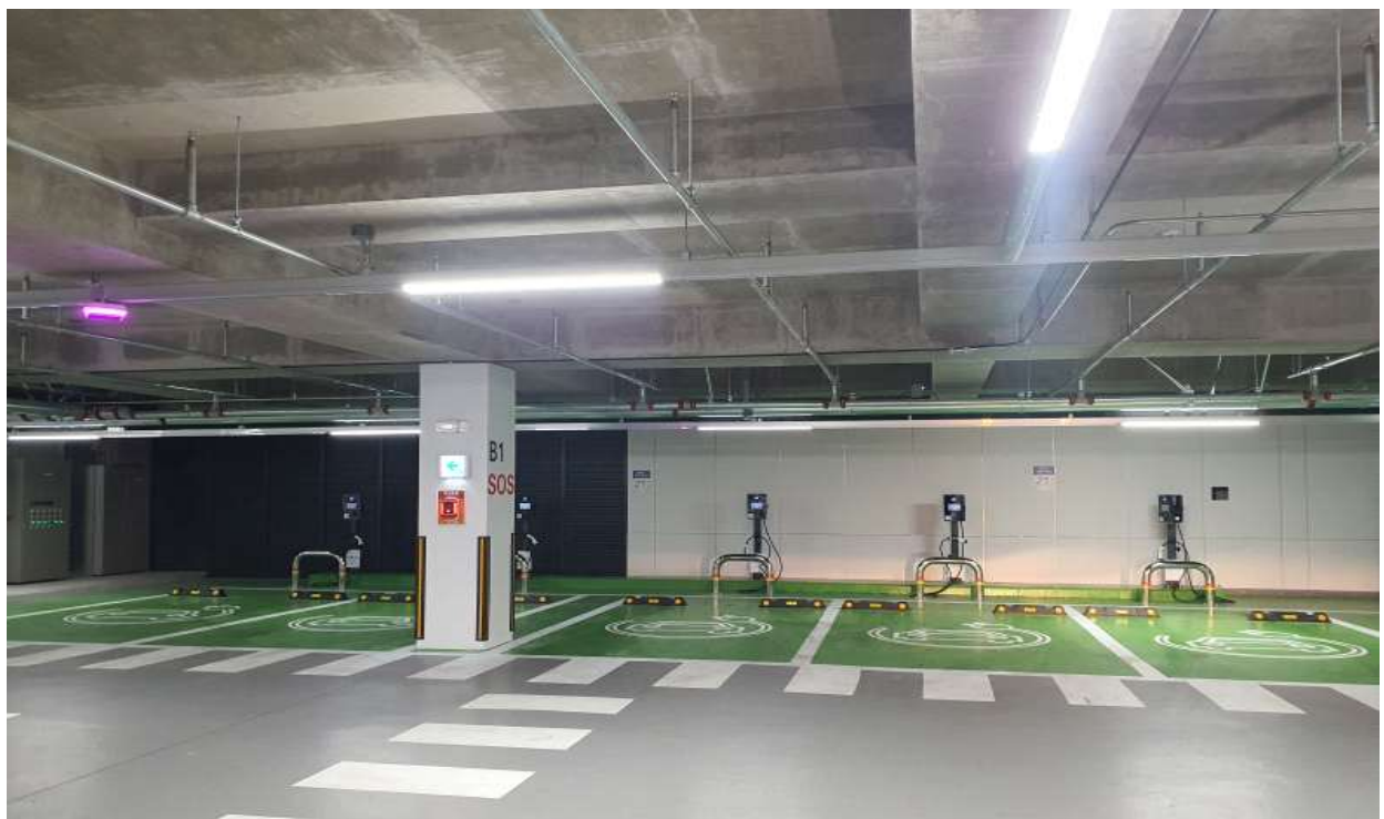
잔디광장 지하1층 주차장 완속충전기: 5대
