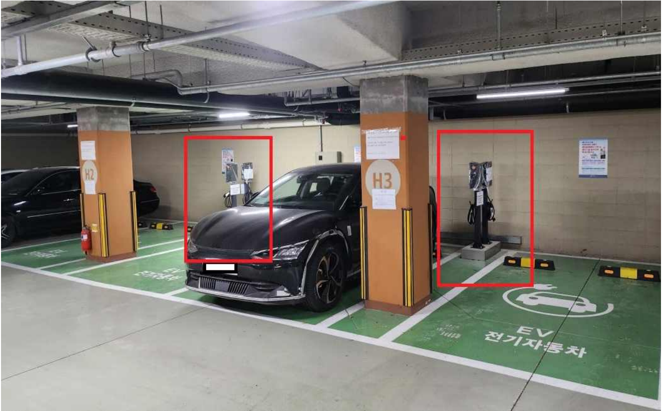
300동(유희진 학술정보관) 지하 주차장 완속충전기 4대
