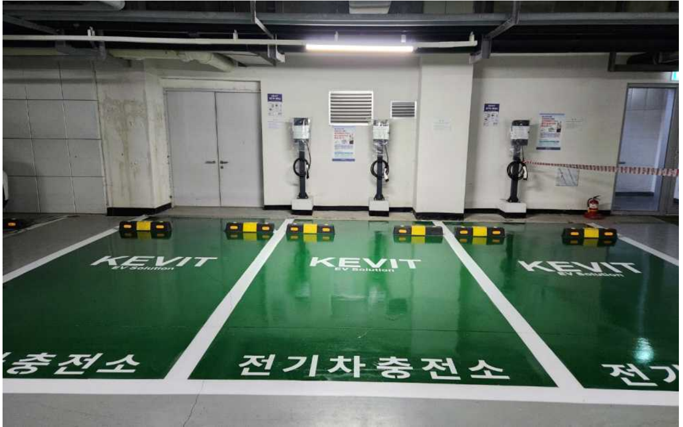
59동(LG경영관) 지하주차장 완속충전기 3대
