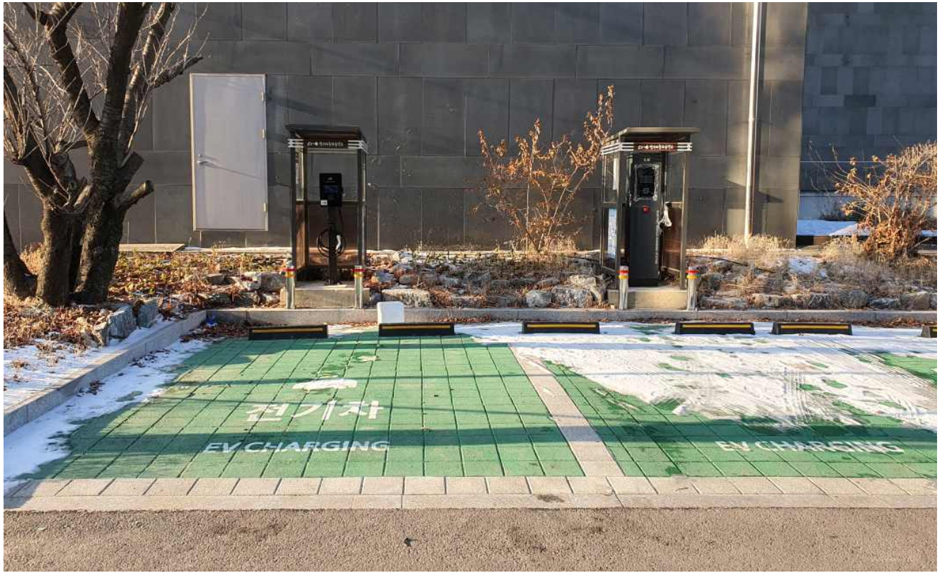
20동(약학관3) 옥외주차장 완속충전기(2대)(1대,2ch)
