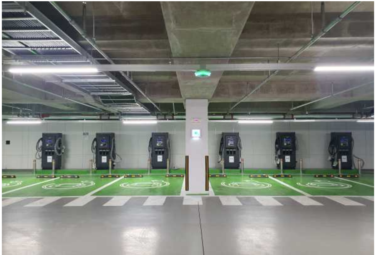
잔디광장 지하1층 주차장 급속충전기: 6대
