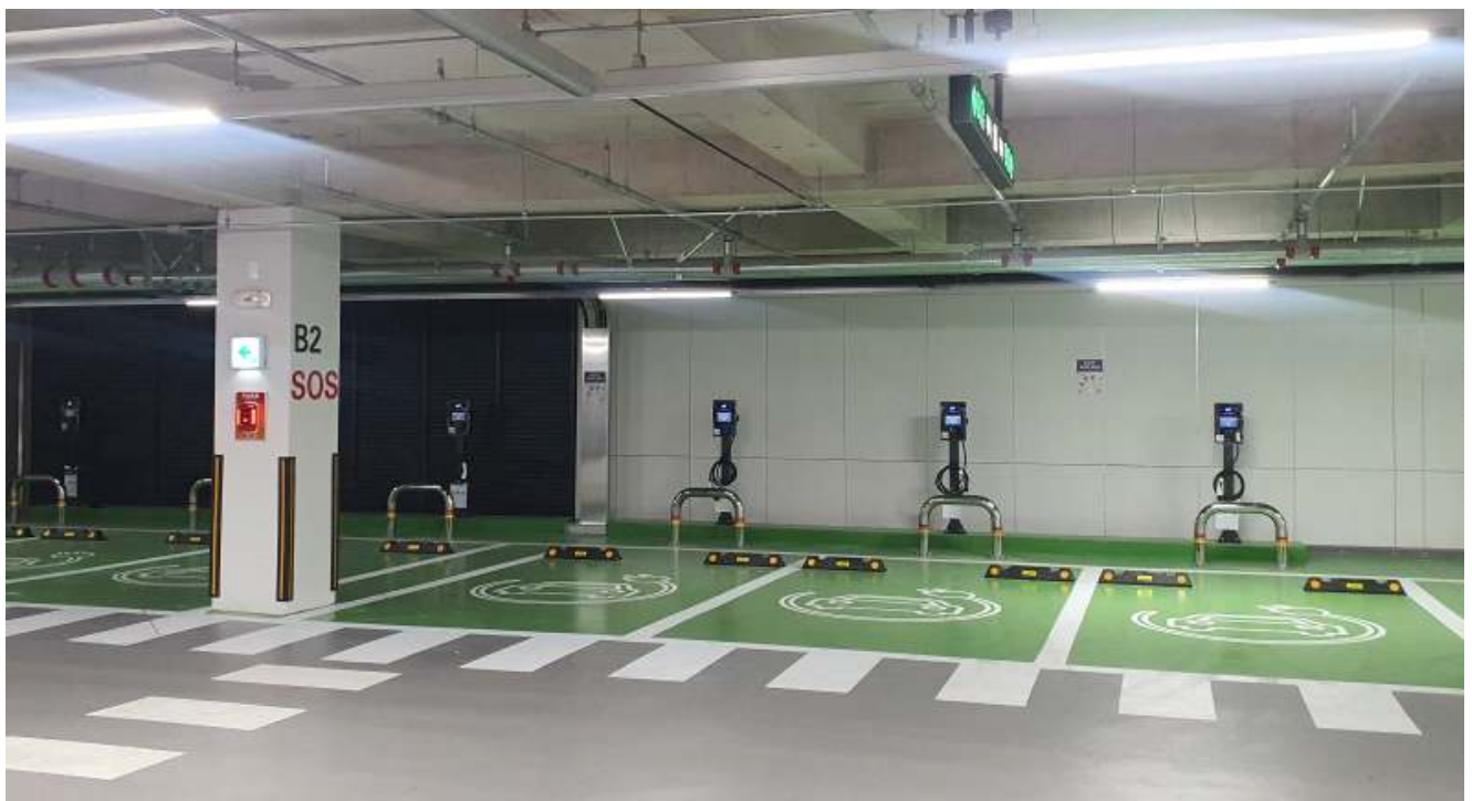
잔디광장 지하2층 주차장 완속충전기: 6대
