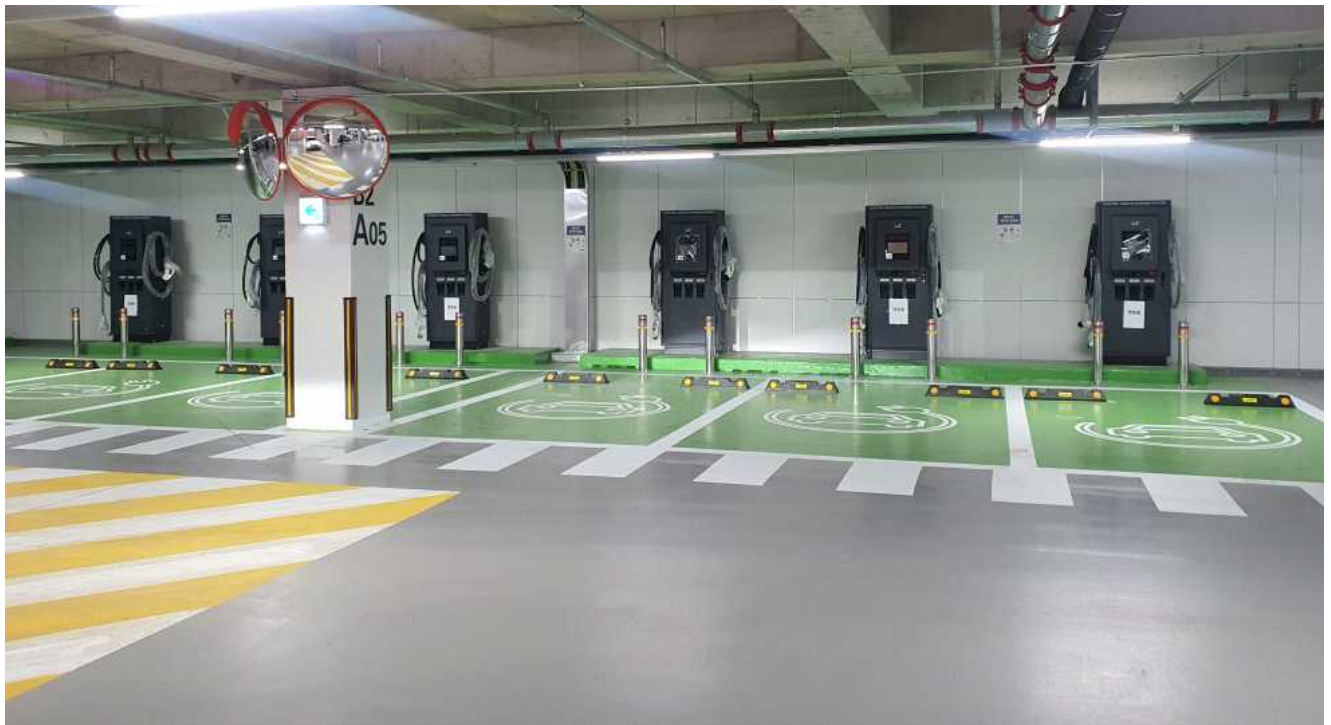
잔디광장 지하2층 주차장 급속충전기 6대
